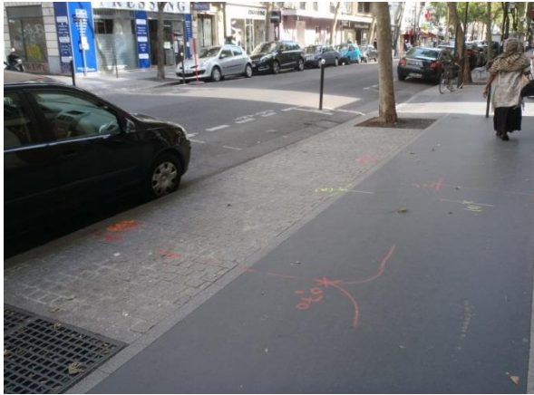
Figure 8 : Marquage sur revêtement urbain
